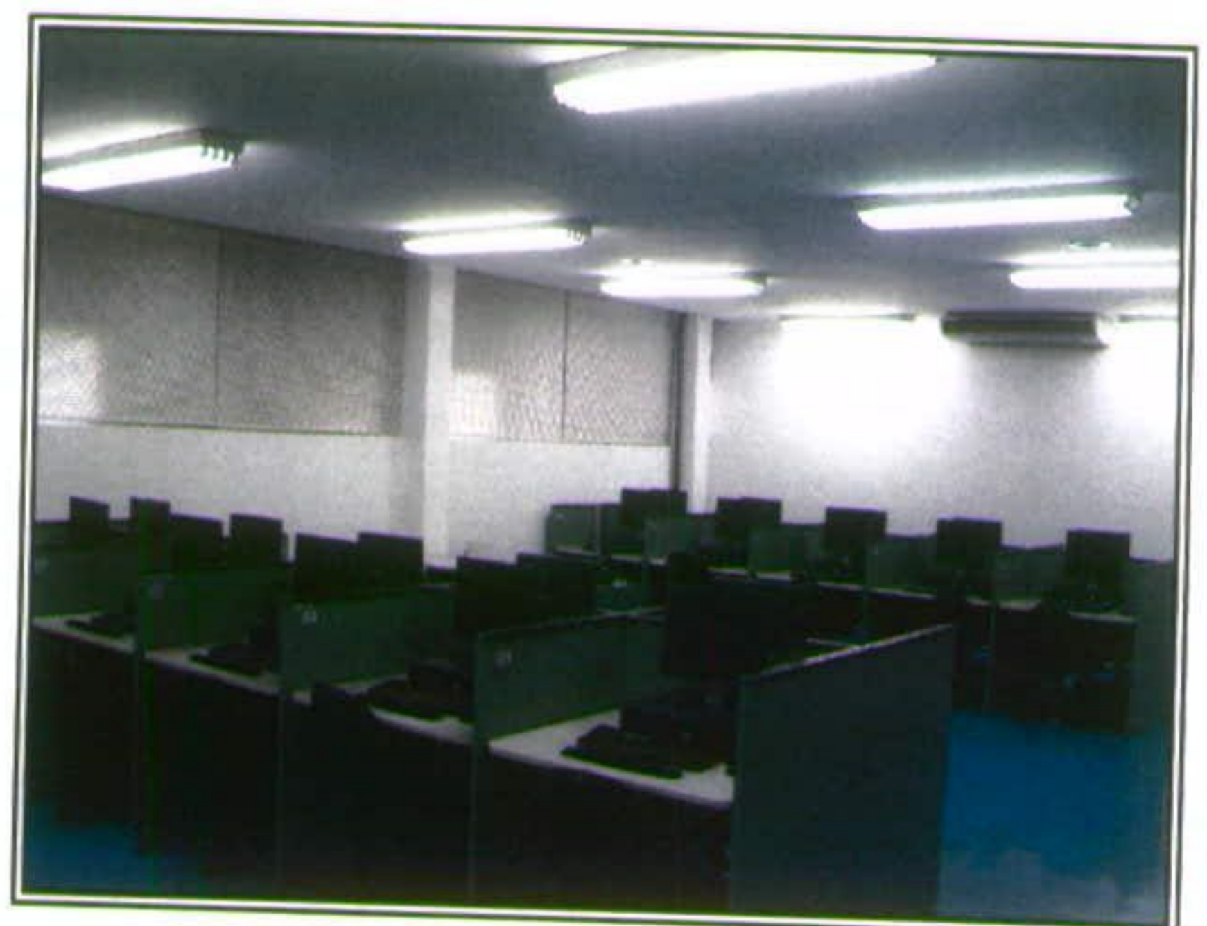
Central de Processamento de Dados
